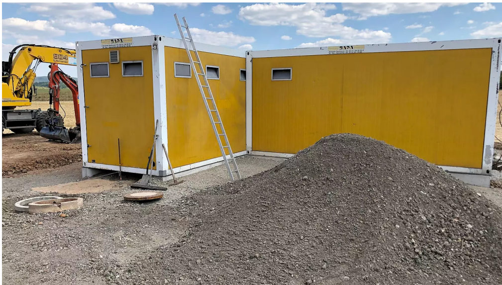
Foto: Michael Petzold | In diesen Containern auf dem Gelände des Bauernhofes ist die Außengruppe des Großbardorfer Kindergartens untergebracht.
